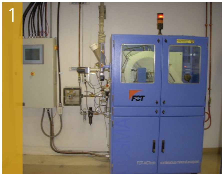
1. ANALIZZATORE COSMA E CONTROLLI PLC COSMA ANALYZER SYSTEM AND PLC CONTROLS
